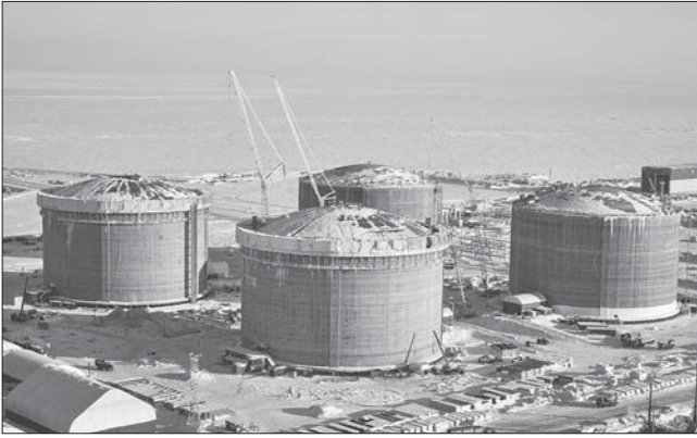
Рис. 18. Железобетонные резервуары для хранения сжиженного природного газа «Ямал СПГ» и для дальнейшей погрузки на плавучий терминал для транспортирования к судовозам, направляющимся по Северному морскому пути в Китай
