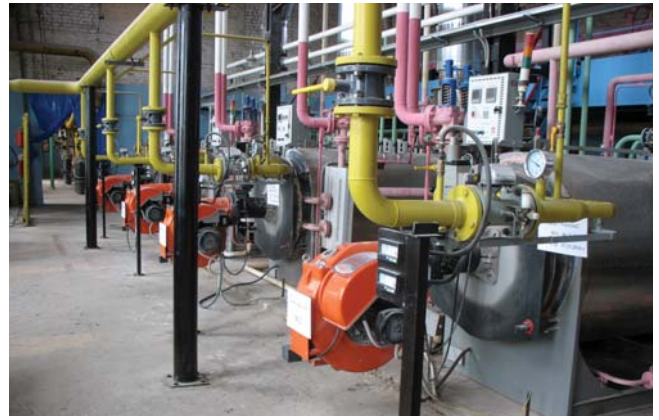
Новые парогенераторные установки
