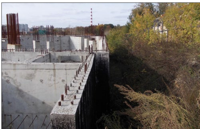
Рис. 4. Отсутствие обратной засыпки пазух
