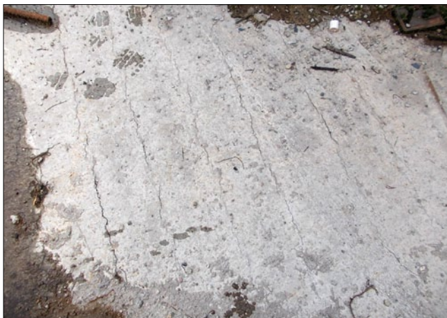
Рис. 2. Сеть трещин на фундаментной плите жилого дома
