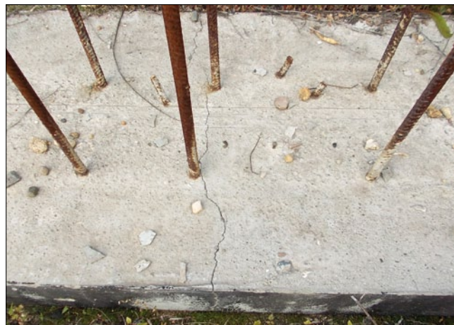
Рис. 3. Трещины в ростверке фундамента паркинга
