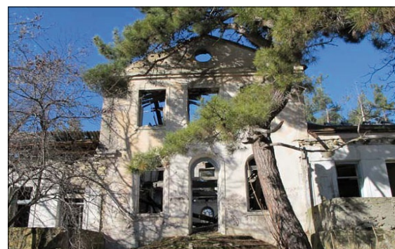
Рис. 5. Полуразрушенное сооружение старого ДКТС. Фото 2011 г.
