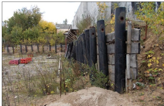
Рис. 1. Состояние подпорной стенки
