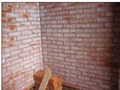
Рис. 2. Высолы на внутренней поверхности кладки
