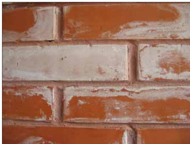
Рис. 4. Высолы на облицовочном кирпиче
