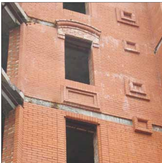
Рис. 5. Фрагменты фасадов здания: слева — нижний этаж после обработки; справа — верхний этаж без обработки
