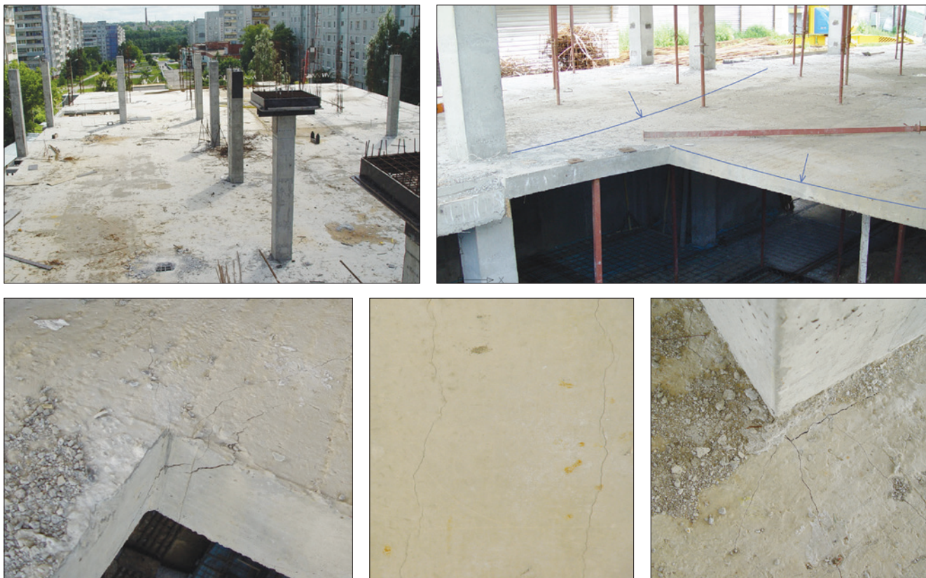
Рис. 3. Значительные деформации и силовые трещины в монолитных перекрытиях
