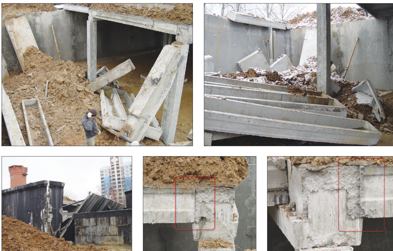
Рис. 4. Состояние сооружения резервуара после обрушения
