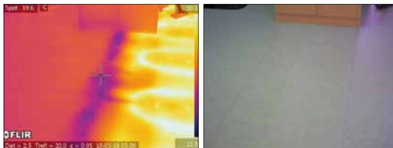
Рис. 4. Тепловизионные исследования цокольного перекрытия на участке стыка модулей. Температурное отклонение до 9°C
