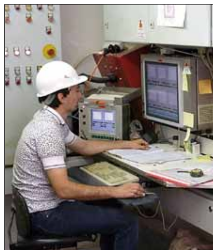
Одна из инъекционных насосных станций ГЦС
