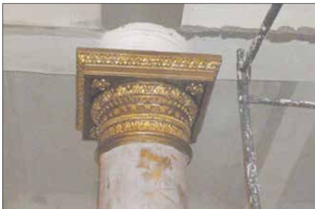
Рис. 3. Одна из колонн первого этажа в момент реставрации капители Fig. 3. One of the columns of the first floor at the time of restoration of a capital
