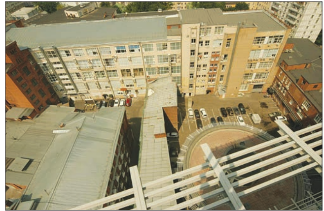
Рис. 8. Общий вид кровли. Участки повреждения кровельного покрытия (вздутия, блюдца, застои воды кровельного покрытия)
