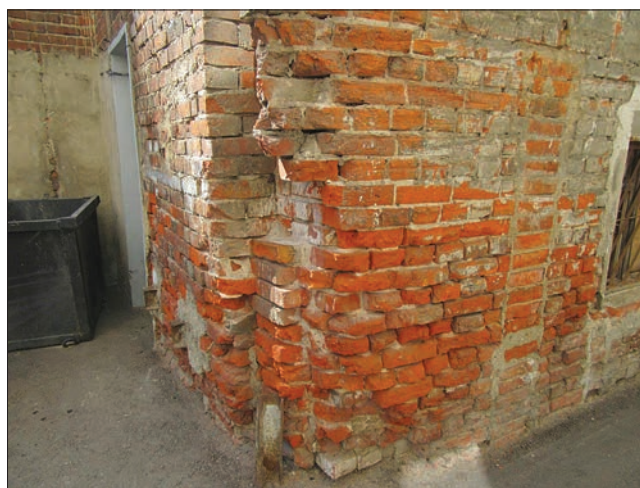
Рис. 4. Увлажнение поверхности стен, выветривание цементно-песчаного раствора, следы высолов Fig. 4. Walls surface moistening, weathering of cement-sand mortar, efflorescence traces
