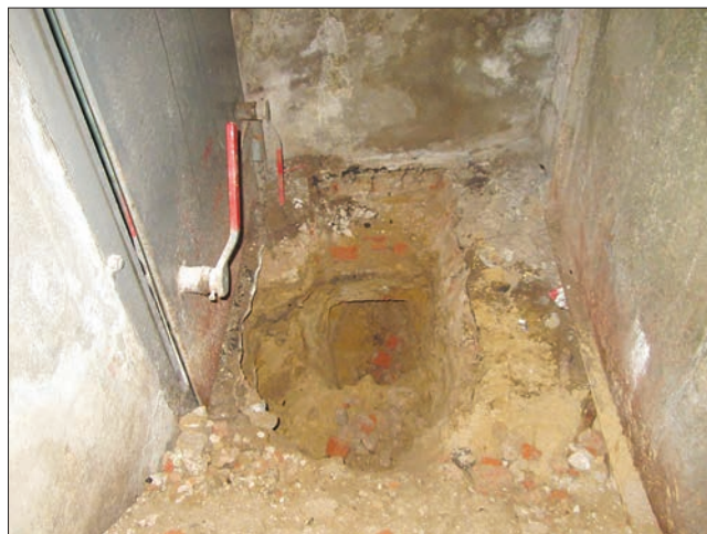
Рис. 3. Отсутствие материалов гидроизоляции стен подвала Fig. 3. Lack of basement wall waterproofing materials
