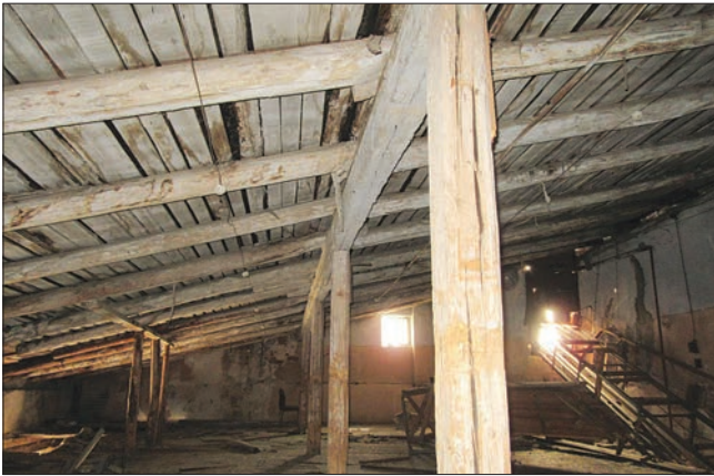
Рис. 7. Увлажнение, гниение, прогибы стропильных ног до 20 мм, в отдельных местах деревянные стойки и стропила имеют дефекты в виде трещин раскрытием до 25 мм
