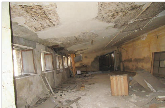
Рис. 6. Обрушение конструкций перекрытия (штукатурки по дранке) вследствие проникания влаги с кровли здания Fig. 6. Floor structures (shingles) collapse due to moisture penetration from the building roof
