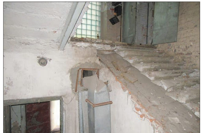
Рис. 9. Разрушение бетона с полным разрушением арматуры ступеней и площадок
