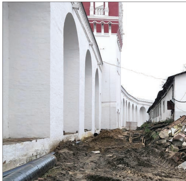
Рис. 5. Прясло между Сетуньской и Затрапезной башнями после прокладки под ним дождевой канализации Fig. 5. Curtain wall between Setunskaya and Zatrappaznaya towers after installation of rainwater pipes under it
