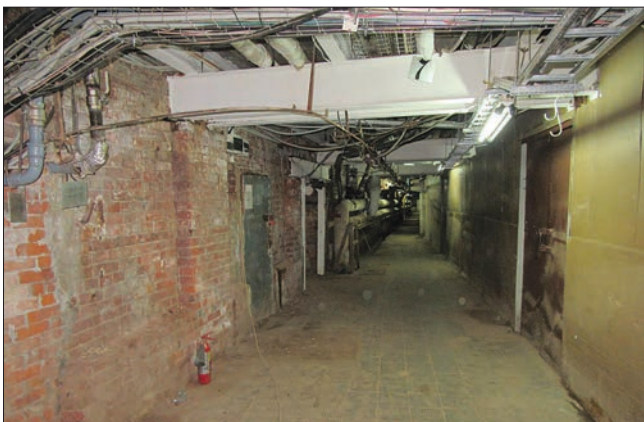
Рис. 5. Общий вид кирпичных колонн подвала. Увлажнение внутренней поверхности колонн подвала, выветривание раствора кладки Fig. 5. The basement brick columns general view. Moisturizing the inner surface of the basement columns, weathering the masonry mortar
