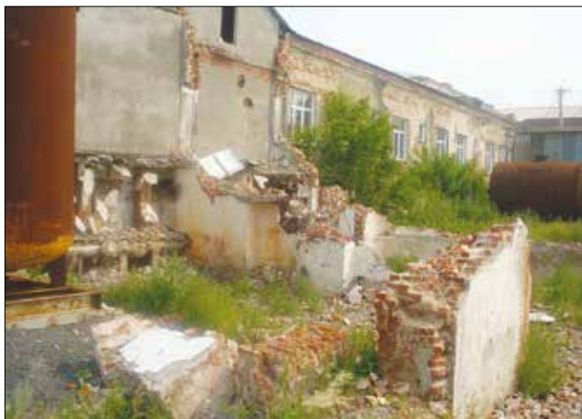
Рис. 9. Разрушение пристройки блока инженерного обеспечения Fig. 9. Destruction of the extension to the engineering support block
