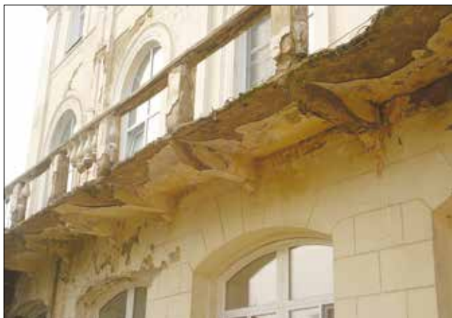
Рис. 7. Разрушение балконов вдоль главного корпуса Fig. 7. Destruction of the balconies along the main building
