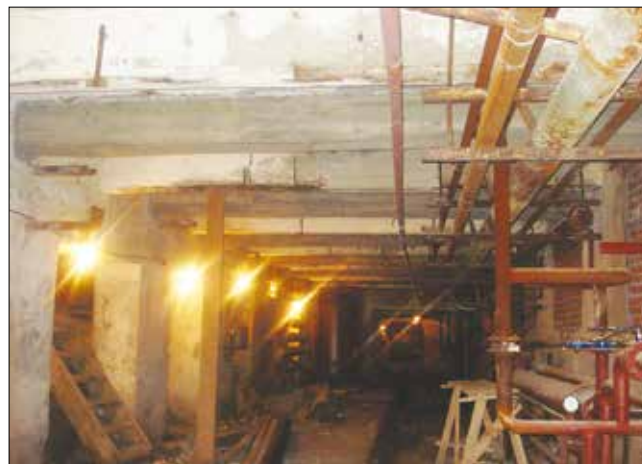
Рис. 10. Коррозионное разрушение металлических конструкций, арматуры монолитных балок железобетонных перекрытий, стальных трубопроводов и крепежных элементов
