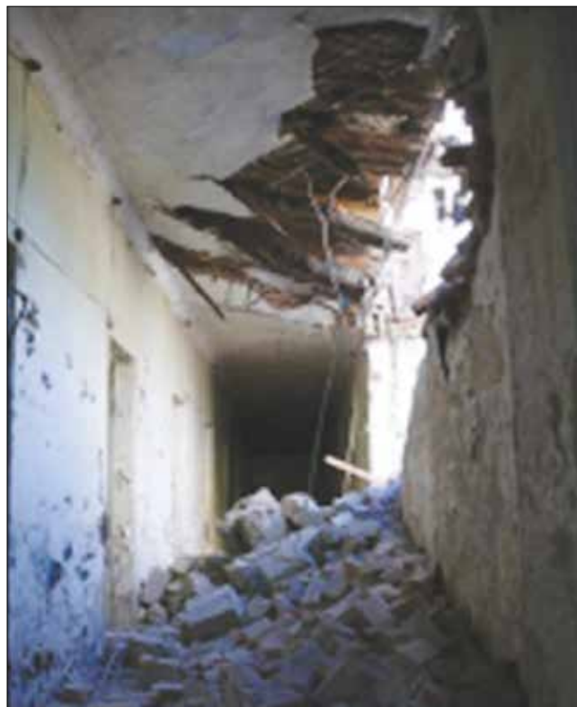
Рис. 8. Разрушение перекрытия и стены входной галереи – крыла главного корпуса Fig. 8. Destruction of the ceiling and wall of the entrance gallery-wing of the main building
