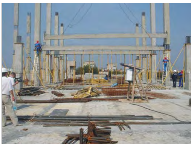
Строительство торгово-развлекательного центра (129 тыс. м 2 ) с применением сборно-монолитного каркаса с пустотным настилом с шагом колонн 15×6. г. Чебоксары. Срок строительства 5 мес.
