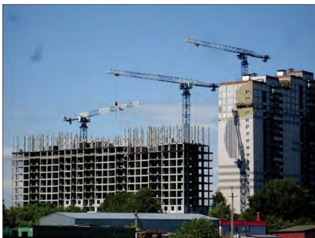
Массовая застройка 25-этажными жилыми домами с применением сборно-монолитного каркаса с пустотным настилом, г. Казань Mass development of twenty-five-story residential buildings using prefabricated monolithic frame with hollow flooring, Kazan
