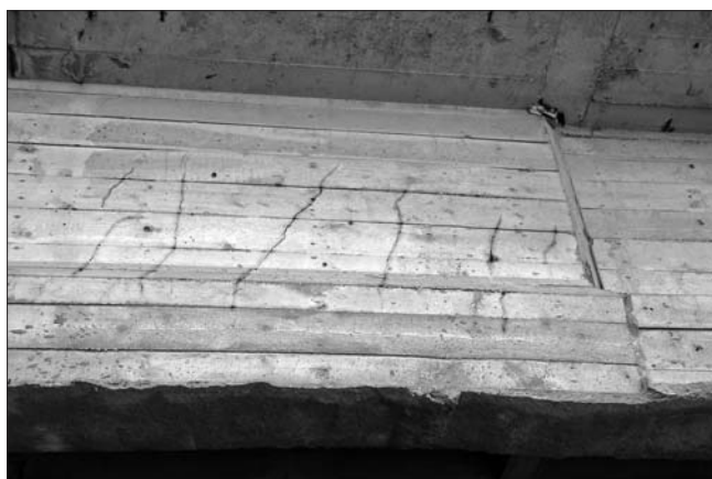
Рис. 1. Путепровод на перегоне Волжский – Трубная, поперечные сквозные трещины в балке и по высоте
