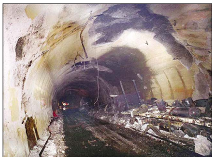
Рис. 1. Последствия пожара в тоннеле Монблан, 1999 г.
