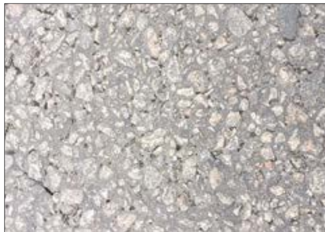
Рис. 1. Верхний слой асфальтобетонного покрытия по ул. Катюкова в Липецке
