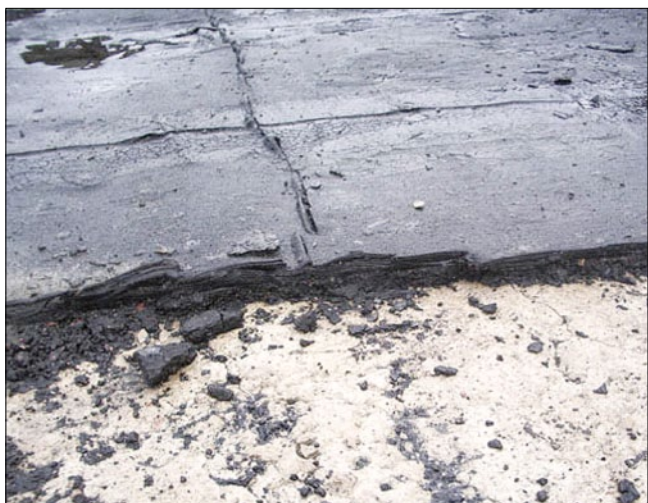
Рис. 1. Гидроизоляционный ковер плоской кровли после многочисленных ремонтов
