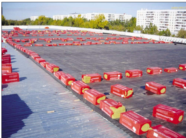
Рис. 5. Внешний вид эксплуатируемой кровли из ПВХ-мембраны (г. Новосибирск, торговый центр «Лента»; площадь поверхности 11000 м 2 )
