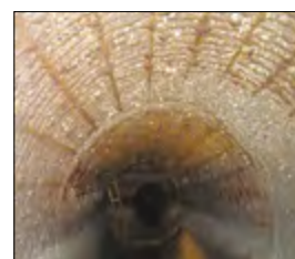
Рис. 6. Разрушение железобетонных труб коллектора из-за микробиологической коррозии [2]
