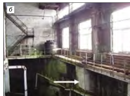
Рис. 4. Разрушение конструкций канализационных насосных станций: а – плиты покрытия; б – стены опускного колодца
