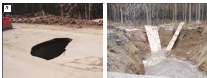
Рис. 5. Образование провала на дороге из-за разрушения коллектора [2, 3]: а – образование провала и один из этапов ликвидации аварии на коллекторе; б – уменьшение стенки трубы коллектора диаметром 1000 мм со 100 до 10 мм за 30 лет эксплуатации
