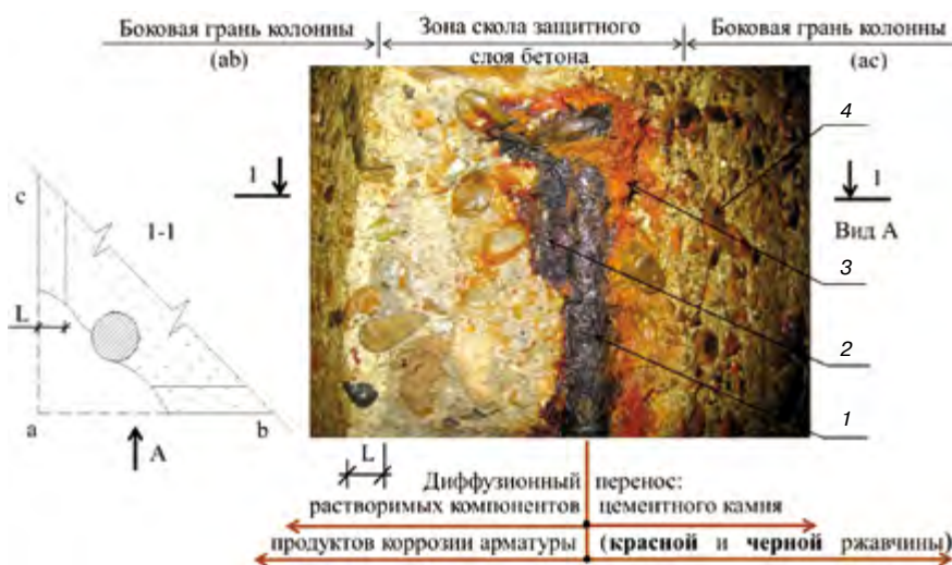
Рис. 3. Скол защитного слоя бетона колонны резервуара питьевого назначения: 1 – продукты коррозии (черная ржавчина) на арматурном стержне; 2 – продукты коррозии арматуры (черная ржавчина), продиффундировавшие от арматуры в направлении внешней поверхности колонны (темно-бурый цвет); 3 – продукты коррозии арматуры (красная ржавчина), продиффундировавшие от арматуры в направлении внешней поверхности колонны (красновато-бурый цвет); 4 – обнажение заполнителя на боковой грани колонны из-за растворения цементного камня; L – глубина нейтрализации бетона
