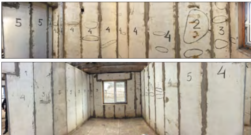
Рис. 5. Техническое состояние ППСБ-панелей после 4 лет эксплуатации под открытым небом. Баллы оценки: 5 – исправное состояние; 4 – работоспособное; 3 – ограниченно-работоспособное; 2 – требуется капитальный ремонт (3% панелей); 1 – требуется замена (нет)
