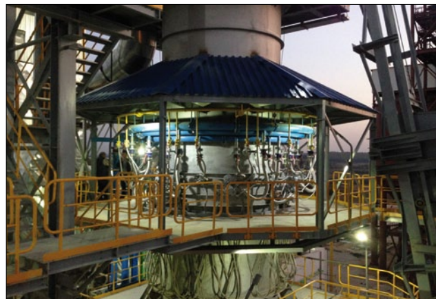
Печи оснащены газовыми горелками
