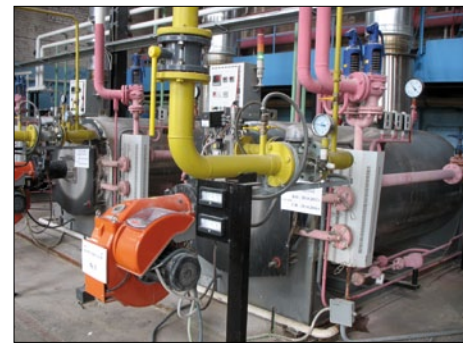
Новое парогенераторное оборудование
