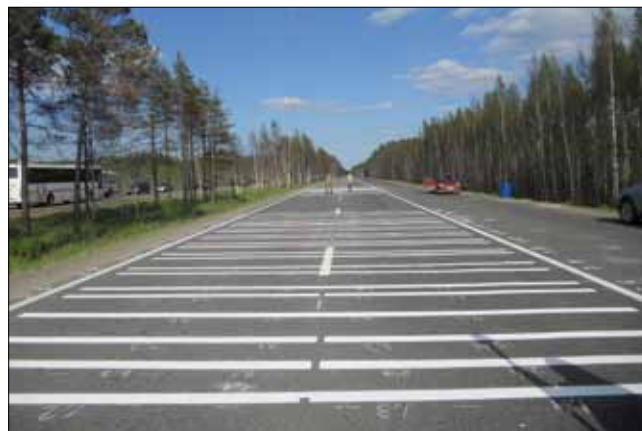
Рис. 4. СПИ 2009–2011 гг. на автомобильной дороге М-18 «Кола» в Ленинградской области
