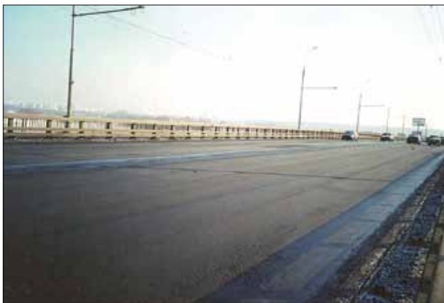
Рис. 4. Покрытие из литой сероасфальтобетонной смеси на Крылатском мосту после трех лет эксплуатации
