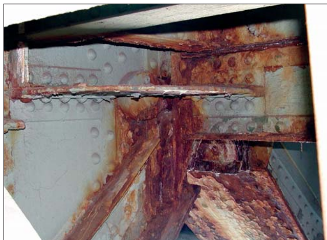
Вид на ферму в зоне замкового шарнира. На нижней поверхности горизонтального листа нижнего пояса видны потеки воды и ржавчины, что привело к распухиванию пакета листов и интенсивной коррозии металла свеса
