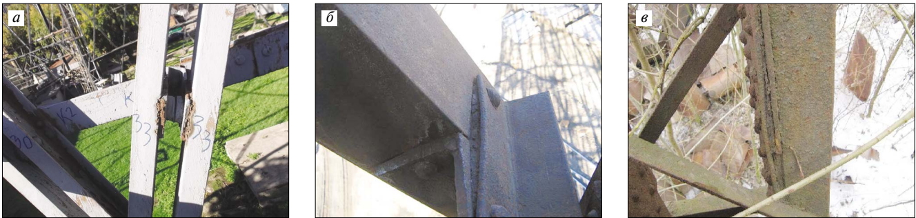
Рис. 1. Примеры проявления щелевой коррозии металлических конструкций: а – Радиобашня В.Г. Шухова (ул. Шаболовка, г. Москва) [1–3]; б – водонапорная башня, г. Выкса (Нижегородская обл.); в – листопркатный цех, г. Выкса (Нижегородская обл.)
