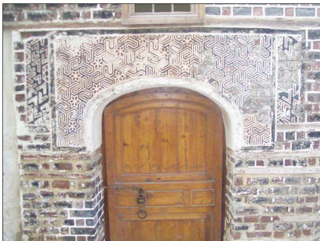
Рис. 6. Дом El maizouny. Деформация кирпича в зоне границ и главной стены фасада
