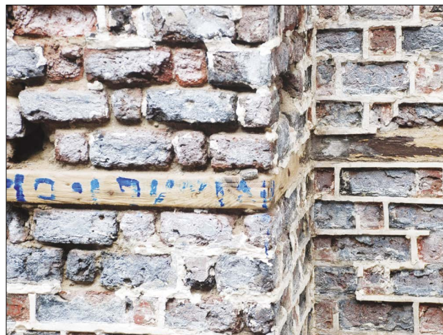
Рис. 7. Высокосообразование на поверхности строительных материалов южной облицовки мечети Al Mahalli
