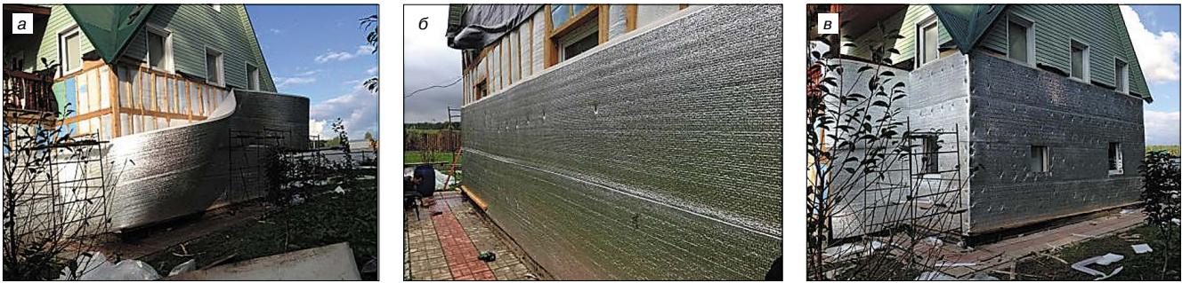
Рис. 1. Теплоизоляция коттеджа: а – разворачивание рулона НПЭ; б – закрепление теплоизоляции и сшивка полотен НПЭ; в – формирование изоляционного контура и оконных проемов
