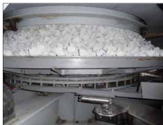
Рис. 9. Вращающийся выгрузочный стол с гидроприводом шахтной печи
