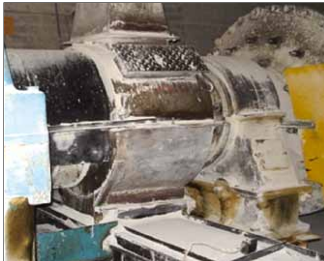
Рис. 5. Узел выгрузки мельницы с установленной щеткой
