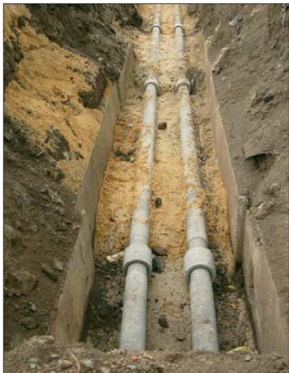
Рис. 5. Локальная тепловая сеть из хризотилцементных труб в поселке автоматнo-механического завода (Челябинск)
