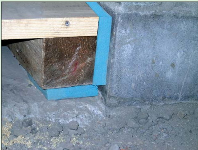
Виброизоляция лаги, примыкающей к вертикальной конструкции, выполняется также материалом Sylomer® с двух сторон
