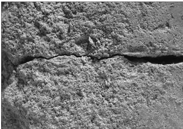
Рис. 1. Трещинообразование фрагмента бетона, вызванное образованием системы этtringит-таумасит
