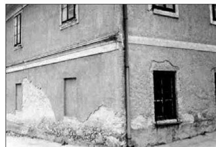
Рис. 1. Разрушение стен зданий из-за капиллярного подсоса грунтовой влаги
