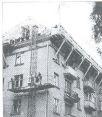
Лыткарино. Реконструкция 4-этажного жилого дома с возведением мансардного этажа без отселения жильцов.
