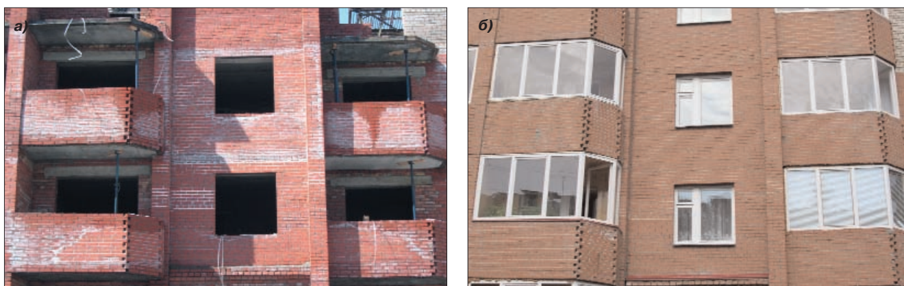
Рис. 2. Естественный смыв высолов в виде высокорастворимых продуктов с поверхности кладки на основе керамического кирпича: а – высолообразование в начале апреля 2004 г. в ходе возведения кладки; б – состояние поверхности стены в мае 2007 г.
