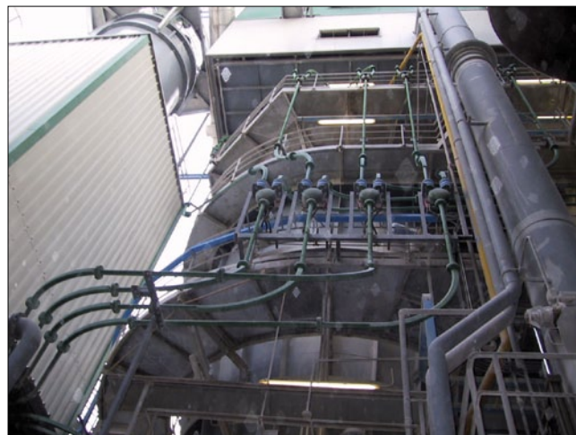
Месторасположение 16: Система сжигания древесной пыли, Fornaci Calce Grigolin SpA, Ponte Della Priula (TR), Италия
