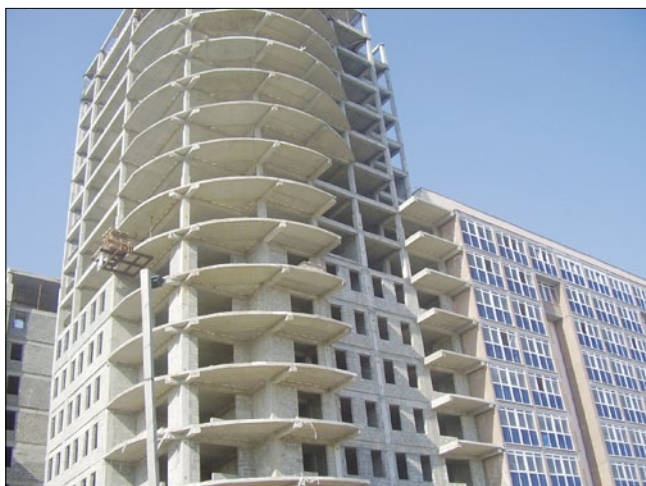
Рис. 4. Строительство 16-этажного жилого дома в Нижнем Новгороде, р-н Верхние Печоры, ул. Родионова, с несущим каркасом Saret (2006 г.)
