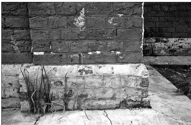
Рис. 1. Нижняя часть фасада здания при сыром подвале
