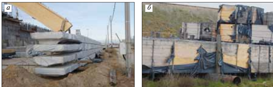
Рис. 2. Хранение КДК на строительной площадке: а – элементы КДК в заводской упаковке; б – полная потеря декоративного вида элементов в результате длительного хранения без защиты от атмосферных воздействий
