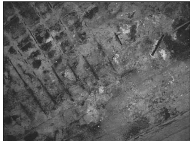
Рис. 2. Разрушение защитного слоя бетона с оголением и коррозией арматуры в плите проезжей части из-за повреждения гидроизоляции (мост через р. Липовку по ул. Фрунзе в Липецке)
