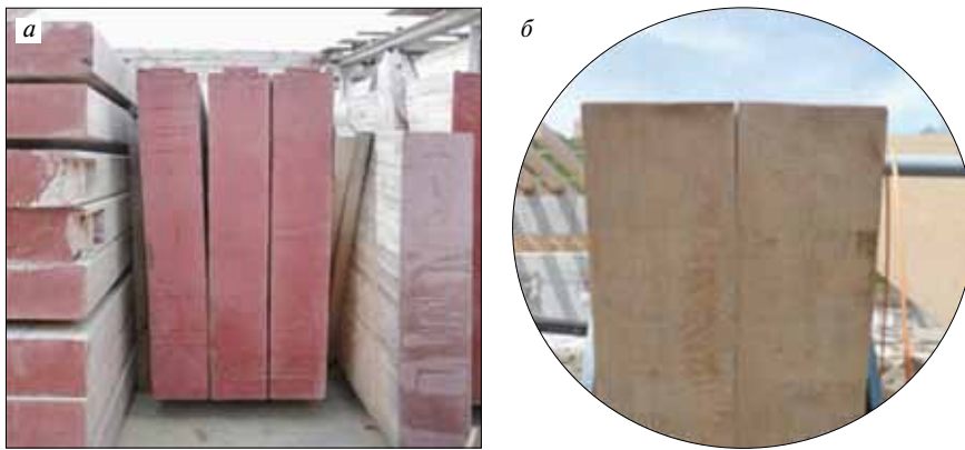
Рис. 5. Деформация сечений клееных элементов в результате прямого воздействия атмосферных осадков: а – отсутствие укрытия при хранении на стройплощадке; б – отсутствие кровли после монтажа КДК
