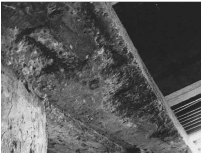
Рис. 1. Замокание, разрушение бетона в нижней части насадки опоры с обнажением и интенсивной коррозией арматуры из-за повреждения гидроизоляции (мост через р. Липовку по ул. Фрунзе в Липецке)
