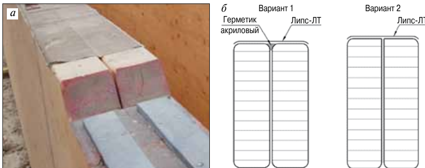
Рис. 6. Провисание ленточного герметика в месте стыка спаренных балок (а) и варианты защиты верхних граней балок (б)
