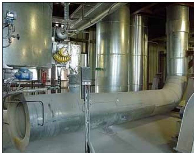
Рис. 11. Пневматическая труба охлаждения
