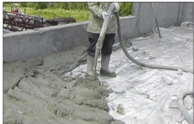
Рис. 6. Утепление эксплуатируемого покрытия монолитным полистиролбетоном марки по плотности D250 по технологии НИИЖБ в здании, строящемся в микрорайоне Куркино (Москва, 2005 г.). Высокопоризованные полистиролбетонные смеси подаются и укладываются в опалубку без виброуплотнения с помощью бетононасосов мобильной установки
