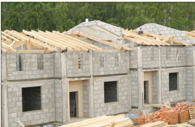
Рис. 5. Возведение кладки наружных (облицованных кирпичом или штукатуркой по сетке) и внутренних стен блок-секций коттеджей типа таунхаус с блоками и перемычками из модифицированного мелкозернистого полистиролбетона марок по плотности D300–D400 в дер. Потапово (р-н Южное Бутово, Москва, 2011 г.)
