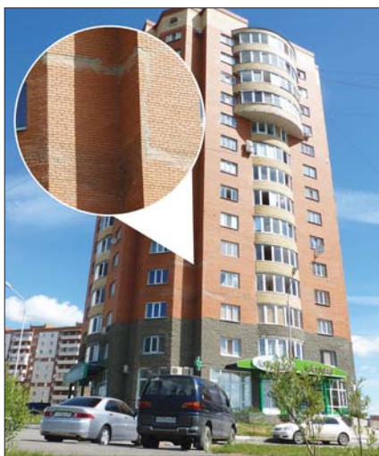
Рис. 2. Разрушение кладки по ул. Крупской, Омск
