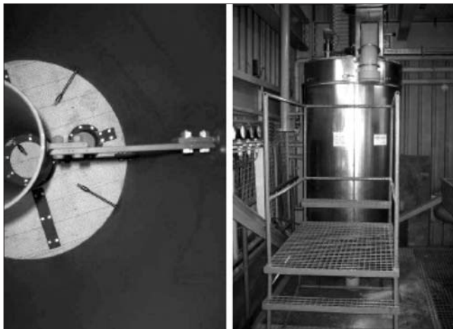
Рис. 5. Слева – внутренний вид гомогенизатора (аэрационное днище и центральный трубопровод); справа – внешний вид гомогенизатора
