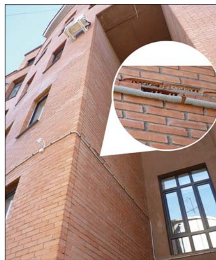
Рис. 3. Разрушение кладки по ул. Краснофлотской, Омск
