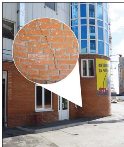
Рис. 1. Разрушение кладки по ул. Кемеровской, Омск
