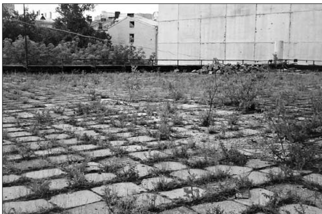
Рис. 1. Кровля здания развлекательного центра «Метелица» до ремонта
