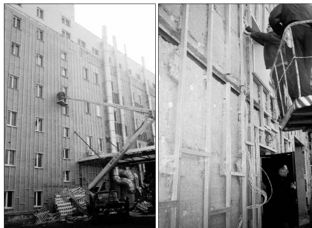
Рис. 2. Монтаж экспериментального участка на стене с вентилируемым фасадом административного здания по ул. Фабрициуса в Минске: а – общий вид фасада на момент монтажа; б – установка термопар по высоте фасада
