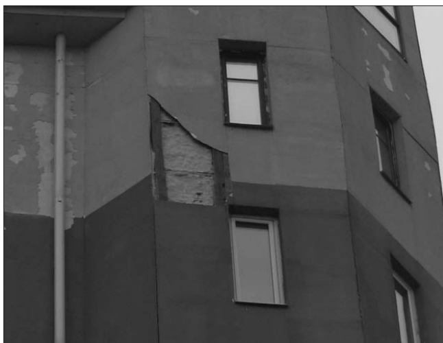
Рис. 1. Фасад здания с выпавшим фрагментом фиброцементного листа и шелушением фактурного слоя декоративного экрана (Уфа, жилой дом по ул. Р. Зорге, 76; введен в эксплуатацию в 1999 г.)
