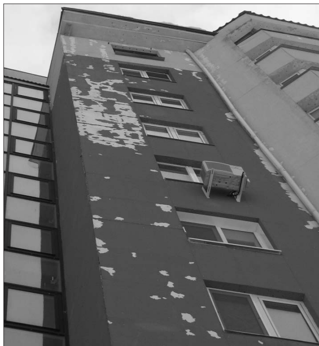
Рис. 3. Шелушение фактурного слоя фиброцементных листов декоративного экрана (Уфа, жилой дом по ул. Р. Зорге, 76; введен в эксплуатацию в 1999 г.)
