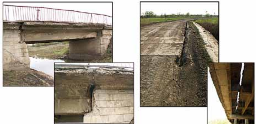
Рис. 1. Аварийные мостовые сооружения на региональных дорогах
