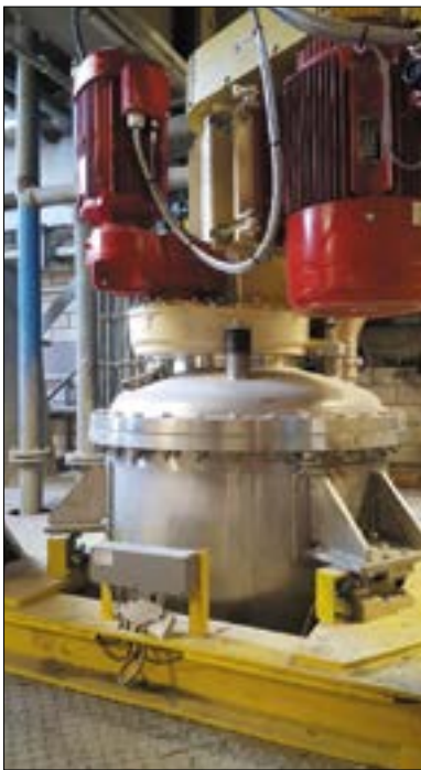
Рис. 1. Суспензионный смеситель на газобетонном заводе
