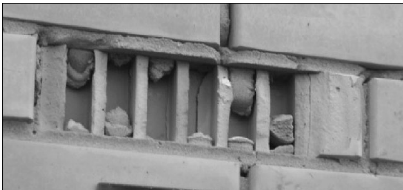
Разрушение кирпича в кладке при замерзании воды в пустотах
