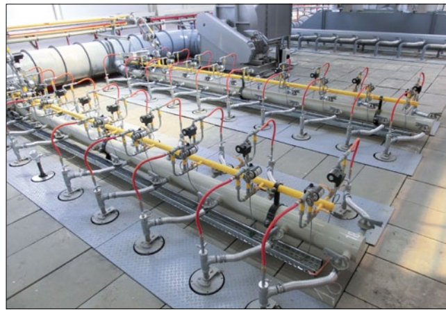
Система горелок на своде печи
