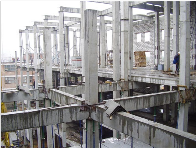
Рис. 6. Возведение сборно-монолитного несущего каркаса колонно-ригельной системы из керамзитобетона классов по прочности на сжатие В22,5–В30, марок по средней плотности D1650–D1800 на высокопрочном керамзите ООО «Новочебоксарский ДСК» для возведения каркасно-панельного здания (г. Новочебоксарск, 2005 г.)
