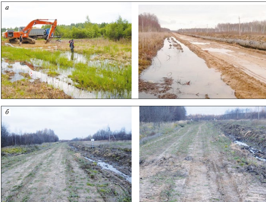
Рис. 16. Состояние участков вдольтрассового проезда МГ «Ярославль–Кириши»: а – в 2009 г.; б – в 2011 г.
