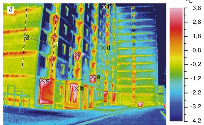
Рис. 2. Термограммы фасадов крупнопанельных жилых зданий с трехслойными наружными стеновыми панелями с плитным утеплителем, перекрытиями и внутренними несущими стенами из тяжелых бетонов: видны концентраторы термонапряжений (оранжевый цвет) в несущих конструкциях из тяжелых бетонов – панелях перекрытий и внутренних стенах, выходящих на лоджии (мостики холода), свидетельствующие о существенных тепловых потерях через них (натурные исследования с помощью тепловизоров выполнены НИИСФ в 2010 г. под руководством Н.П. Умняковой): а – общий вид введенных в эксплуатацию крупнопанельных зданий (Московская область); б – термограммы фасадов зданий
