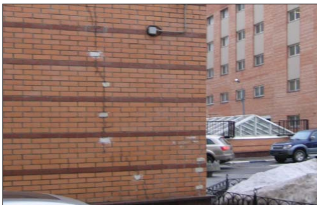
Рис. 1. Разрушение облицовочного слоя из лицевого пустотелого керамического кирпича в 18-этажном жилом здании (Москва, ул. Зоологическая)
