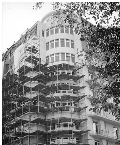
Рис. 1. Строительство монолитного жилого десятиэтажного дома в Челябинске. Стена из ячеисто-бетонных блоков и наружной теплоизоляционной вермикулитовой штукатурки толщиной 15 мм
