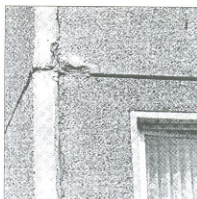
Рис. 4. Дефекты панели до реконструкции фасада (угловой скол)
