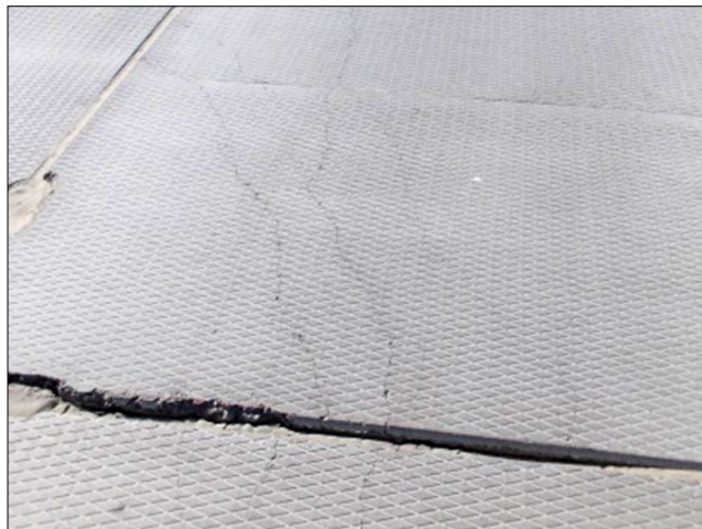
Рис. 3. Трещины в плитах
