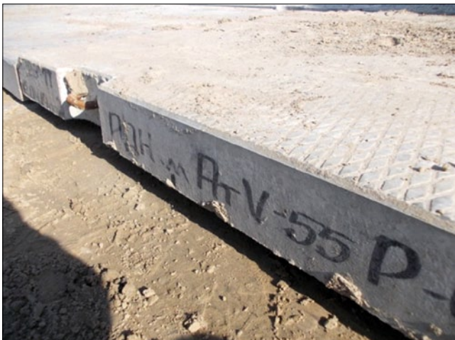
Рис. 2. Отсутствие опирания края плиты на основание из-за вымывания песка
