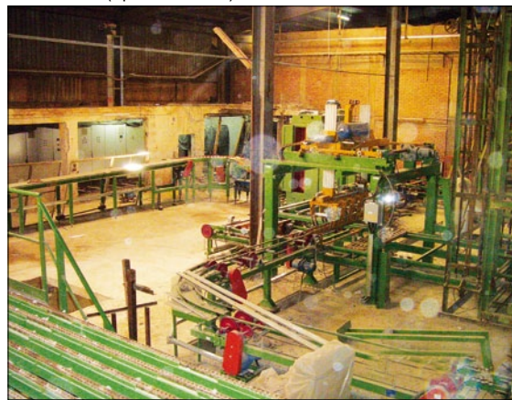
Линия по производству черепицы на заводе BMSD
