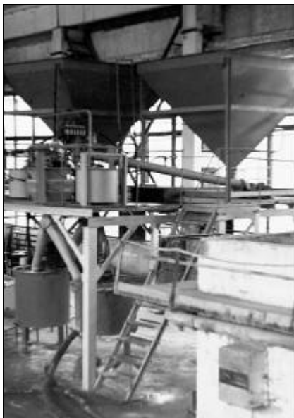
Общий вид установки по производству пенобетона
