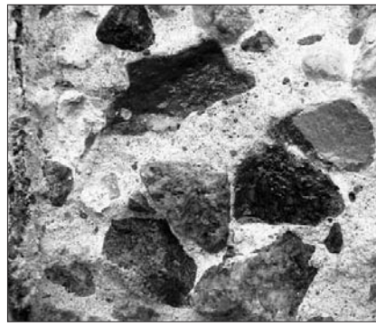
Рис. 2. После удаления зерна крупного заполнителя и обработки поверхности индикатором бетон под удаленным зерном окрашивается в малиновый цвет здорового бетона ( pH > 9 )
