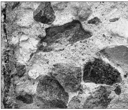
Рис. 1. Слой гипса между зернами заполнителя, оставшийся после водоструйной обработки под давлением 250 атм
