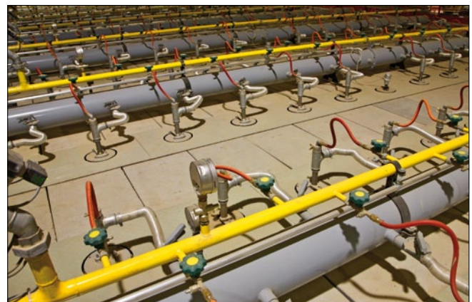
Потолочные горелки на своде туннельной печи
