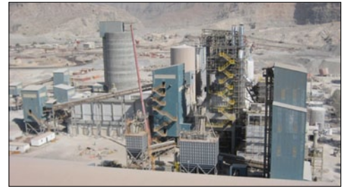
Рис. 6. Общий вид рабочей площадки новой производственной линии
